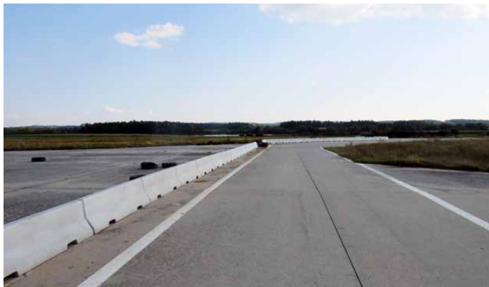
nové dopravní zábrany na bývalém letišti
